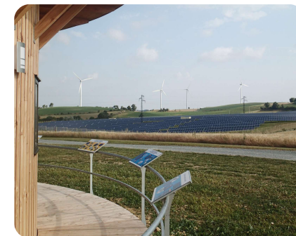
Maison pédagogique parc éolien et solaire d'Avignonet-Lauragais (31)
